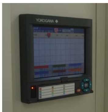
Fig5-2 温度コントローラ
